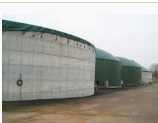
Les digesteurs et la cuve à digestat
